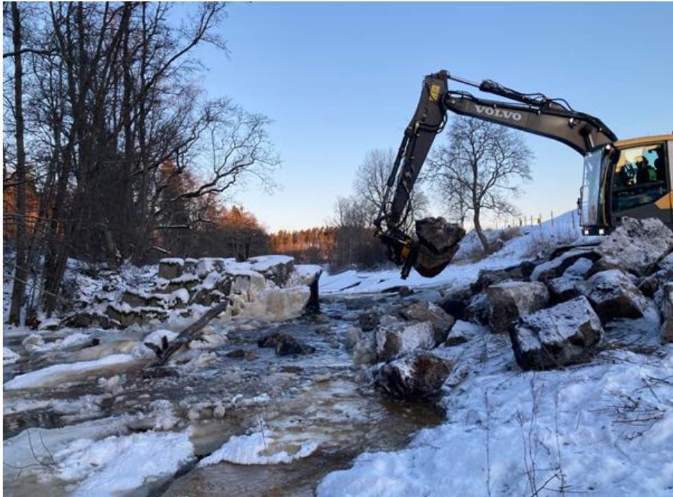
Bild 17 Den ena delen av dammen plockas bort. Korslöts golfbana. Foto: Viktor Kärvinge
